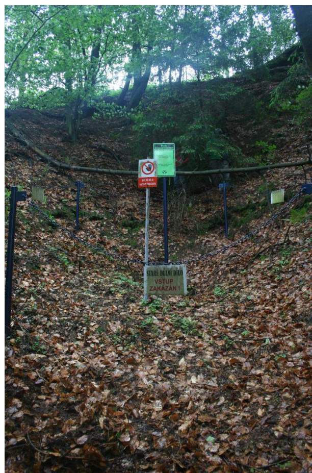
(Obr. 7) Propadlina nad zavalenou štolou
